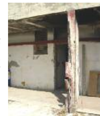
φωτ. 4. κτίριο Β2: υποστήλωμα με αποκόλληση σκυροδέματος σε μεγάλη έκταση
