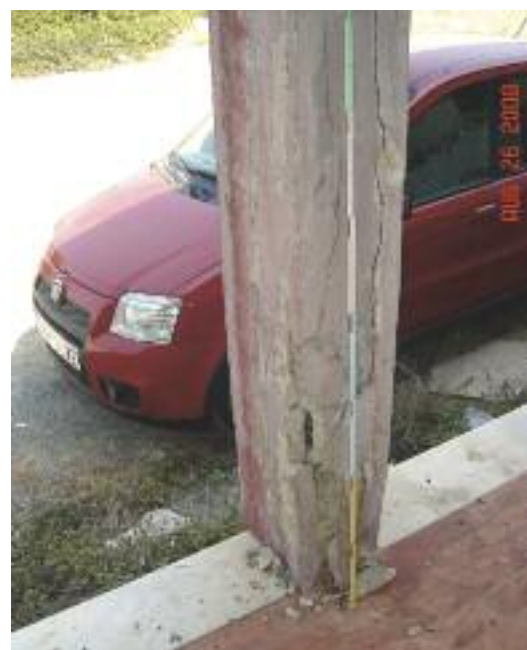
φωτ. 2. κτίριο Β6: υποστήλωμα με αποκόλληση ακμών
