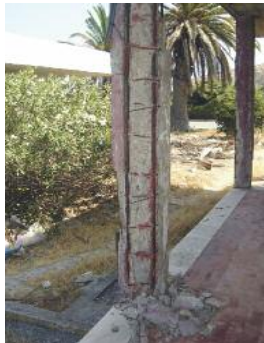
φωτ. 7. κτίριο B7: υποστήλωμα με αποκόλληση σκυροδέματος σε μεγάλη έκταση
