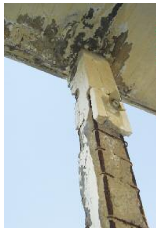
φωτ. 3. κτίριο Α: υποστήλωμα με αποκόλληση σκυροδέματος σε μεγάλη έκταση
