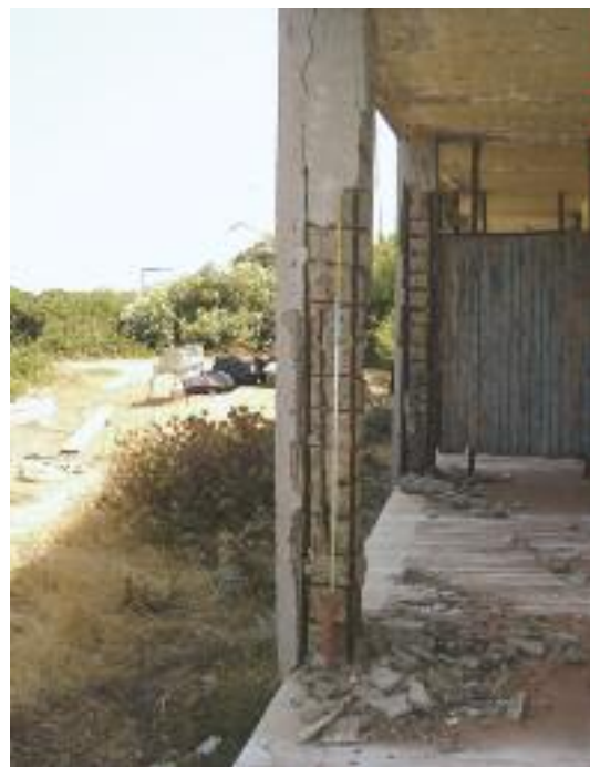
φωτ. 6. κτίριο B2: υποστήλωμα με αποκόλληση σκυροδέματος σε μεγάλη έκταση
