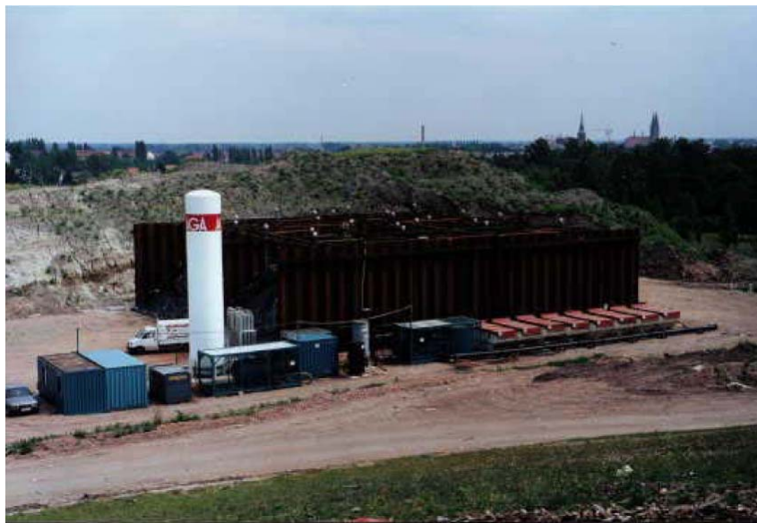
Εικόνα 1. Σύστημα Biopuster στο Stendal της Γερμανίας (Koelsch et al. , 1998).
