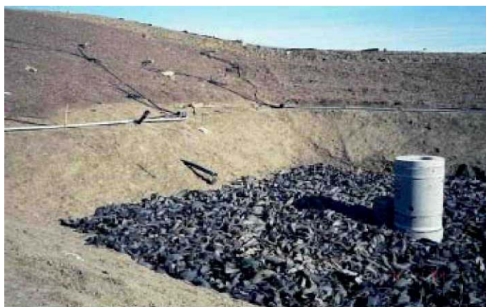
Εικόνα 22. Αερόβιο φρεάτιο εγκατεστημένο και έτοιμο για πλήρωση (Yazdani et al. , 2005).
