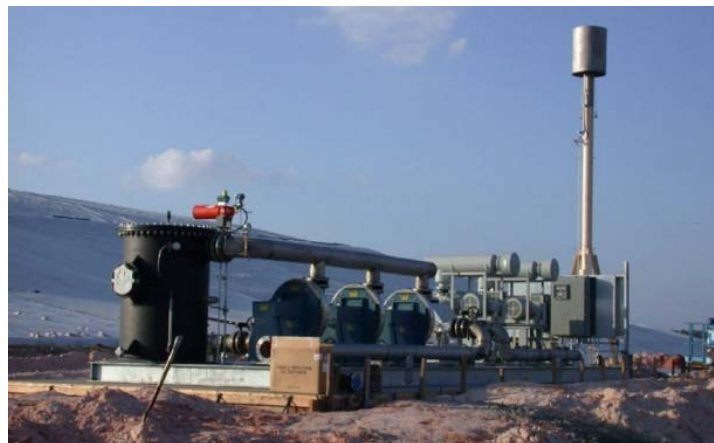
Εικόνα 35. Συμπιεστής - Εξαγωγή βιοαερίου (State Water Resources Control Board, 2005).
