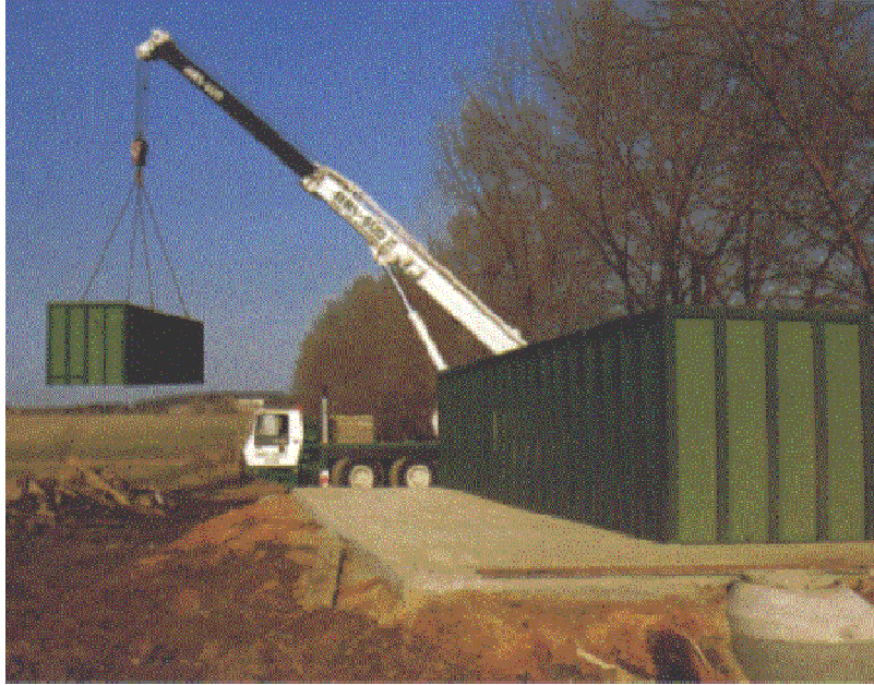
Εγκατάσταση συστήματος 2000 ατόμων
